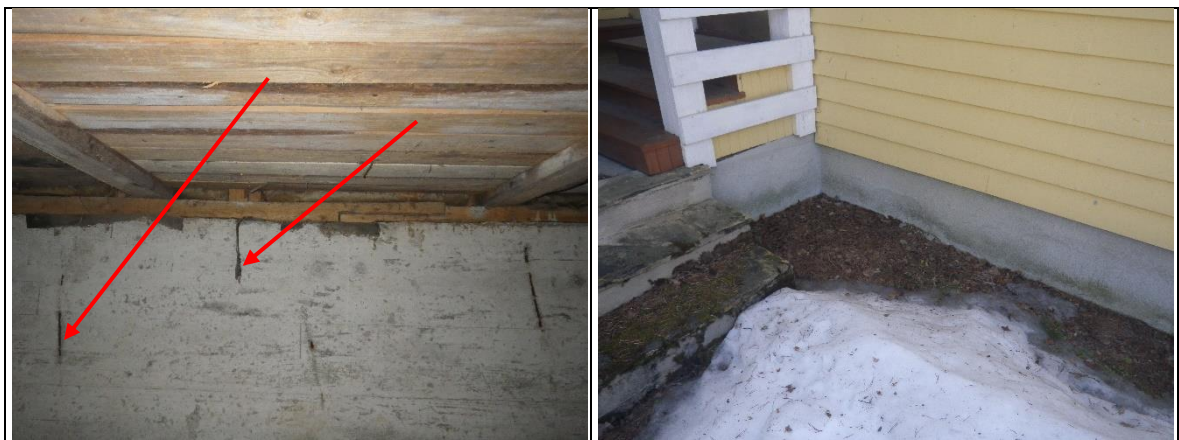
Sokkelipalkissa korrosiovaurioituneet teräkset näkyvissä ryömintätilassa.
