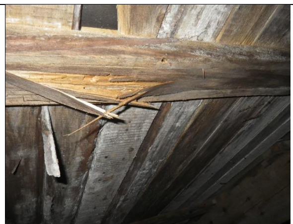
Alapohjan kantavissa puupalkeissa pitkälle edenneitä lahovaurioita.
