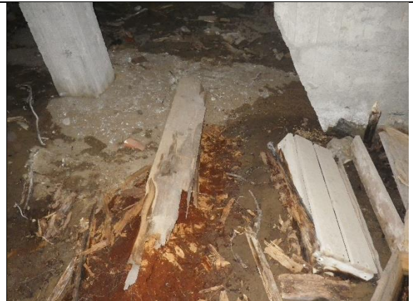
Lahoavaa rakennusmateriaalia ryömintätilan maapohjan päällä.
