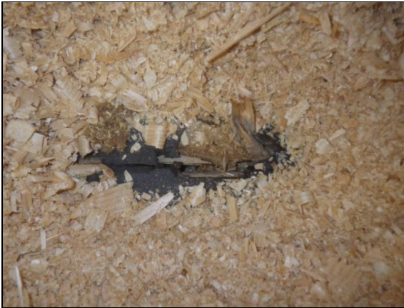
Alapohjarakenteen tervapaperia ja lahovaurioitunutta aluslaudoitusta.
