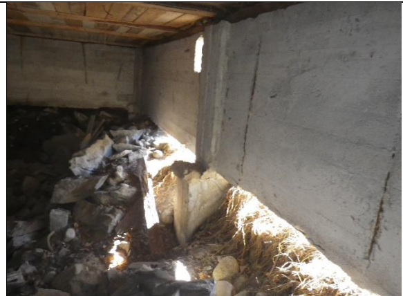
Sokkeli on paikoin auki alaosastaan.
