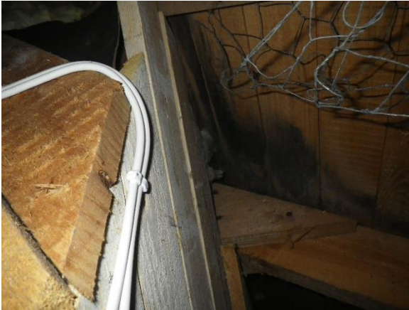
Vesikaton paikallinen kosteusvaurio.
