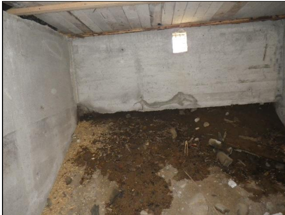
Ryömintätilaan valuu pintavesiä ulkopuolelta.
