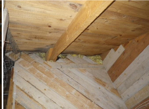
Vesikattorakenteessa ei toteudu tuuletus.
