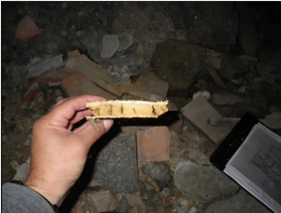
Aluslaudoitus on paikoin läpilaho.
