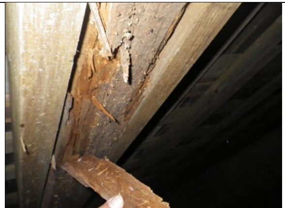
Vahvistetun alapohjapalkin lahovaurio.
