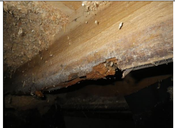
Poikittaispalkkien alaosan lahovaurio.
