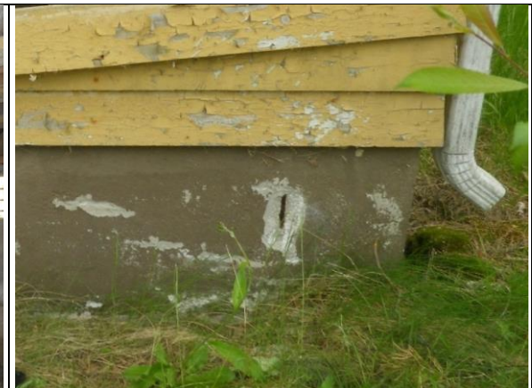
Sokkelin betonipinnan vaurioita ja teräksen korrosiovaurio.
