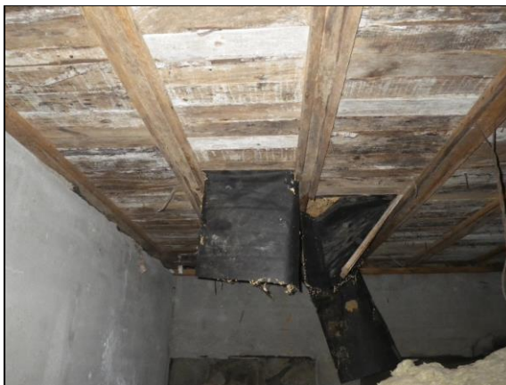
Alapohjan aluslaudoitus ja eristeet ovat pudonneet.
