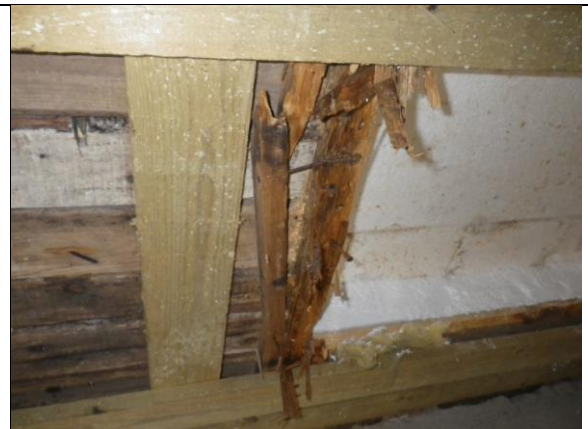
Poikittaispalkissa pitkälle edennyt lahovaurio betonilaatan kohdalla.
