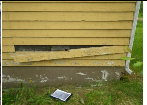
Julkisivun pinnoitevauriot keskittyvät seinän alaosaan.
