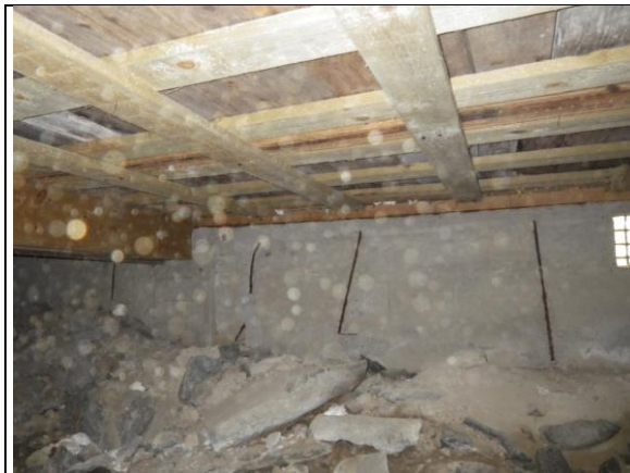
Sokkelipalkissa teräkset näkyvissä.
