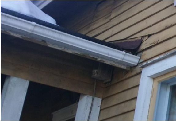
Katoksen räystäärakenteen vaurioita.
