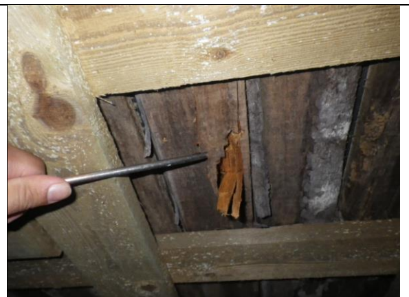
Aluslaudoitus on tuetulla osalla lahovaurioitunutta.
