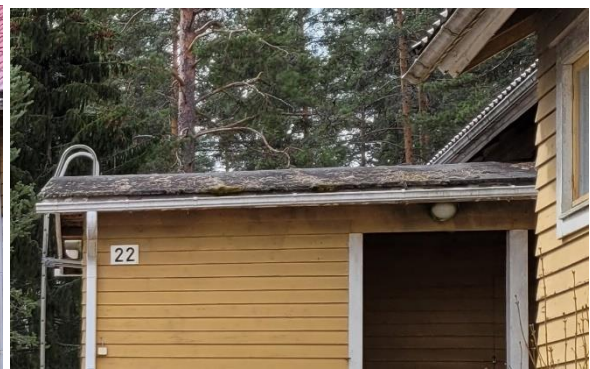
Huopakaton sammaloitumista sisääntulon päällä.
