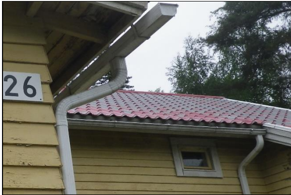
Maalipinta kulunut tiilikuvioidusta peltikattosta.
