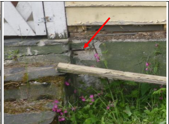
Sokkelin betonipinnan vaurioita ja teräksen kor- rosiovaurio.
