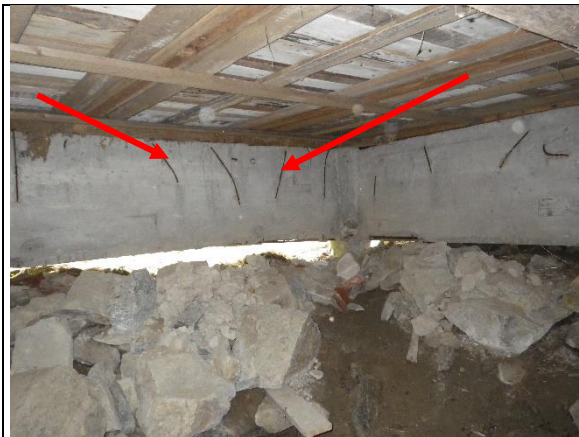
Sokkelipalkissa korrosiovaurioituneet teräkset näkyvissä.
