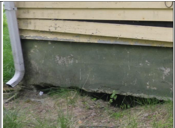
Vesikaton sade- ja sulamisvedet jäävät rakennuksen vierustalle/ohjautuvat ryömintätilaan.
