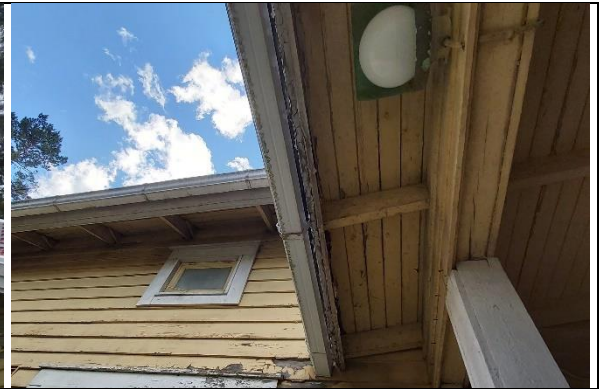
Räystä ja julkisivu kosteusvaurioitunut.
