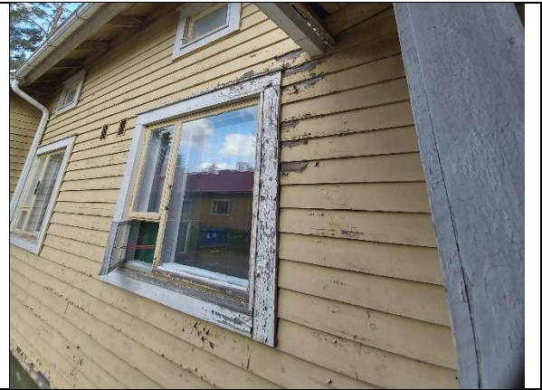
Räystäskourusta valuu vesi julkisivuun vaurioit- taen ulkoverhousta.
